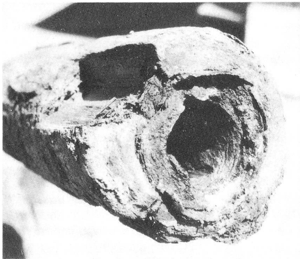
Das vorliegende Bild zeigt ein Teilstück der ausgegrabenen Teuchelleitung. Das Fundstück befindet sich beim städtischen Bauamt, wo übrigens auch der 2,5 m lange Bohrer aufbewahrt wird, mit dem einst die Föhrenstämme für die Teuchelleitung gebohrt wurden.
