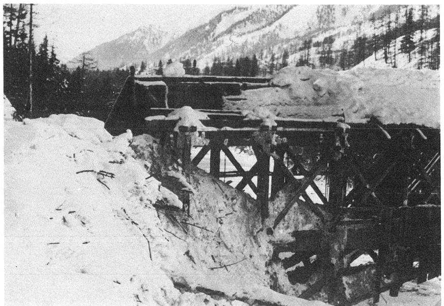
Ende Januar 1951 beschädigte die «Urezza»-Lawine die «Punt Nova», eine alte Holzbrücke bei Zernez. Foto Forstinspektorat GR, Chur
