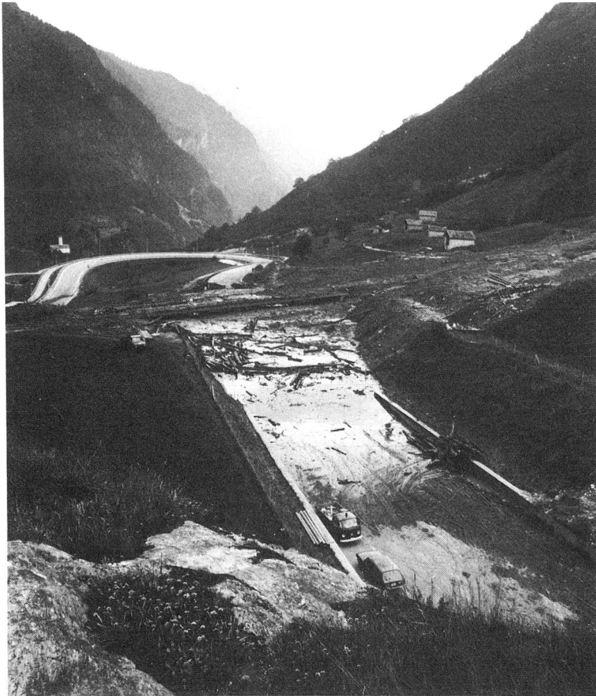
Bei Mesocco hat die «Orsora»-Rüfe die N 13 überschüttet. Foto Kant. Tiefbauamt GR, Chur
