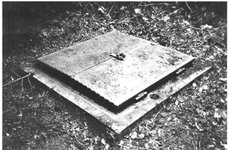
187 Einige Meter entfernt fällt einem der quadratische Schachtdeckel auf. Darunter befindet sich der Einstieg. Foto 2005.
