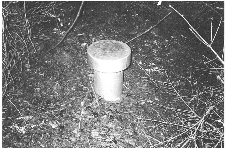
186 Gewöhnlich erkennt man im Gelände die Lage eines ASU am Stutzen des Entlüftungsrohrs, zum Beispiel im Oberannwald. Foto 2005.
