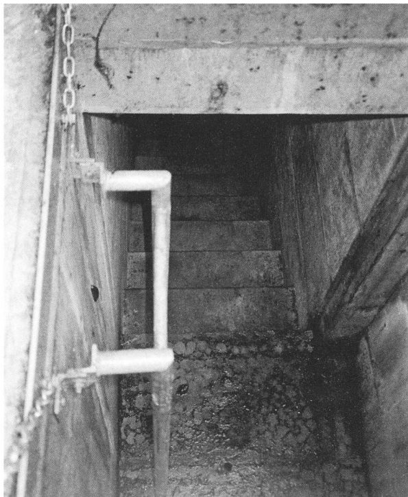
188 Eine Eisenleiter erlaubt den Abstieg, weiter unten sind noch einige Treppenstufen sichtbar, die zur Eingangstür führen. Foto 2005.
