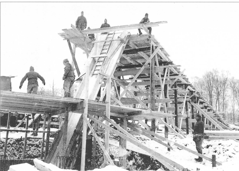
79 Damit die Gleise vom Materialplatz zur Baustelle horizontal verlegt werden konnten, war eine Brücke zu zimmern. Der Rutschkännel ist im Bau. Bald kann der Beton eingebracht werden.
