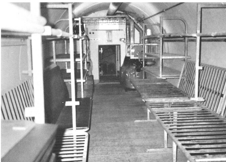
192 Blick gegen den Eingang. Rechts davon die Filteranlage. Foto 2012.
