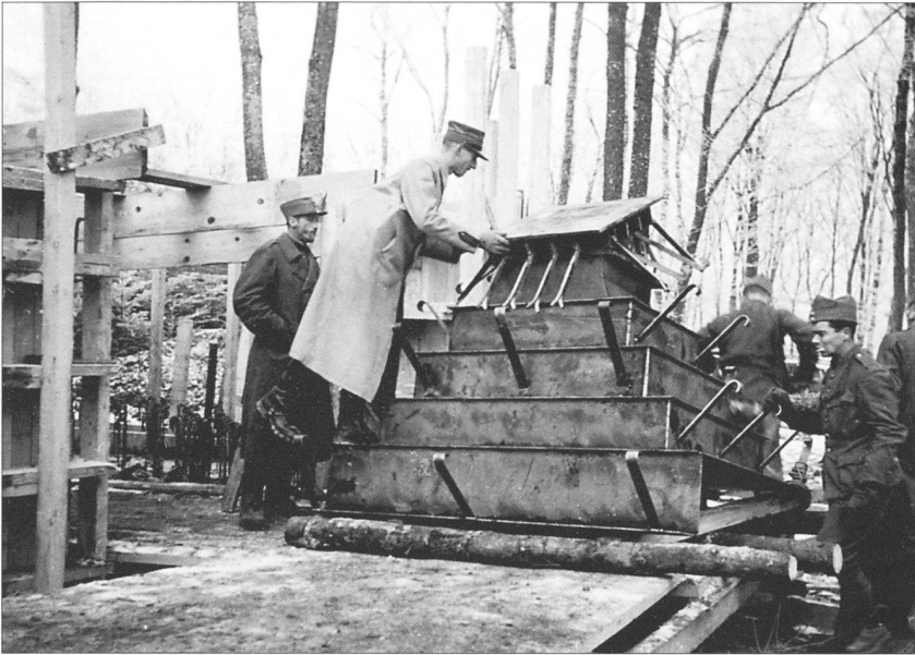
77 Die Schartenverkleidung aus Winkeleisen (unten) und die Abdeckung für die Frischluftöffnung (oben) sind eingetroffen. Sie müssen in die Schalung eingepasst und in den Beton eingegossen werden.
