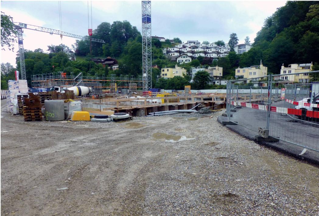
Die momentan grösste Baustelle Burgdorfs: die Überbauung am Uferweg (Foto: Viktor Kälin)
