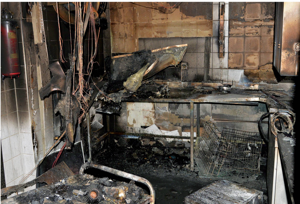
Teile der Restaurantküche im Schloss Burgdorf sind komplett ausgebrannt (Foto: Archiv D'REGION)
