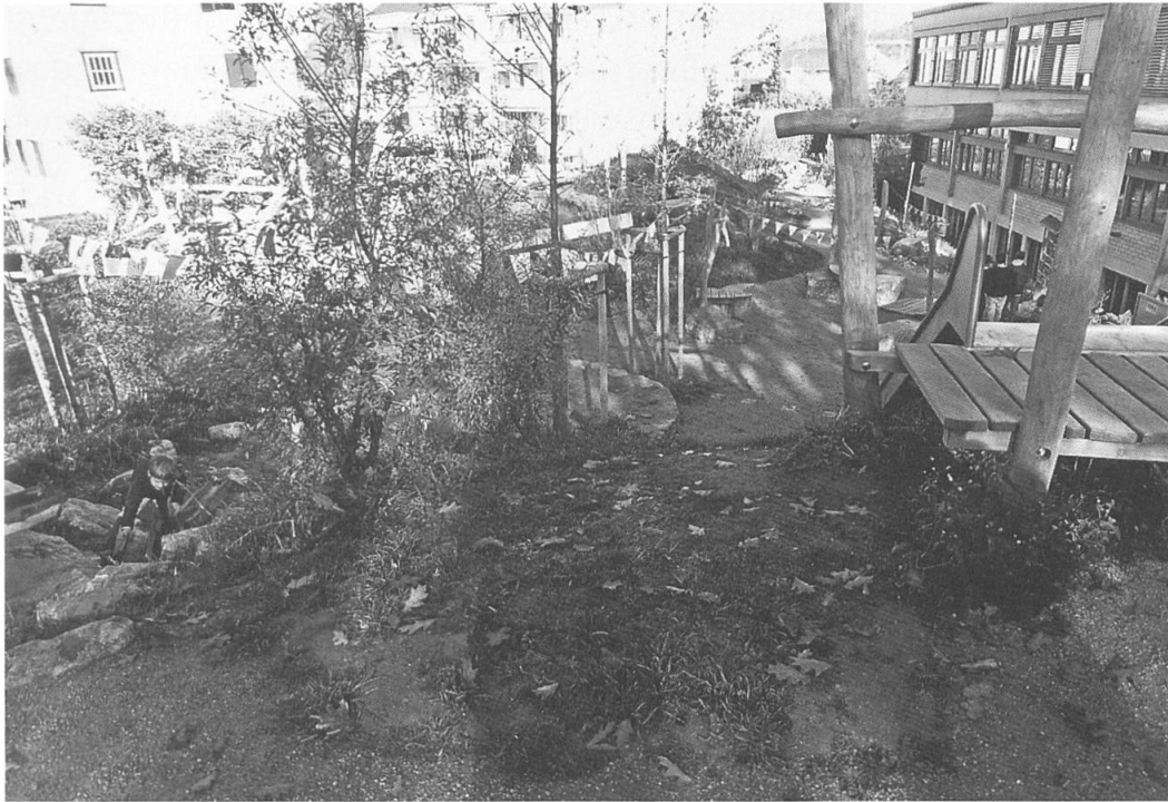
Von März bis September 2015 wurde der Pausenplatz der Schulanlage Gsteighof erneuert und ausgebaut – mit viel Fronarbeit der gesamten Schülerschaft
