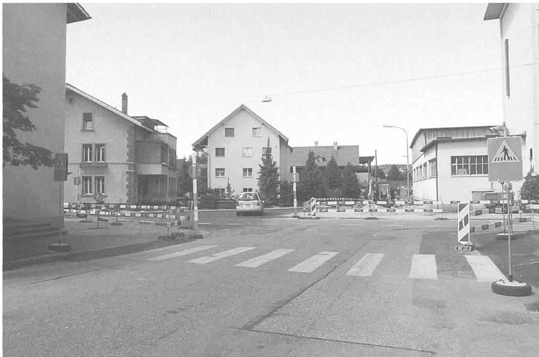
Der Umbau der Aebi-Kreuzung zu einem grossen Kreislauf hat Anfang Juli 2008 begonnen
