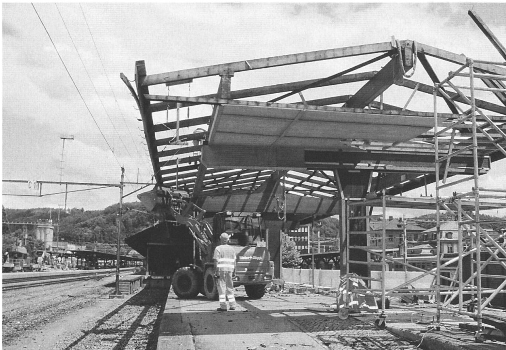
Mitte Juni 2007 hat der grosse Bahnhof-Umbau begonnen. Der langgezogene Güterschuppen auf der westlichen Seite ist bereits abgerissen worden
