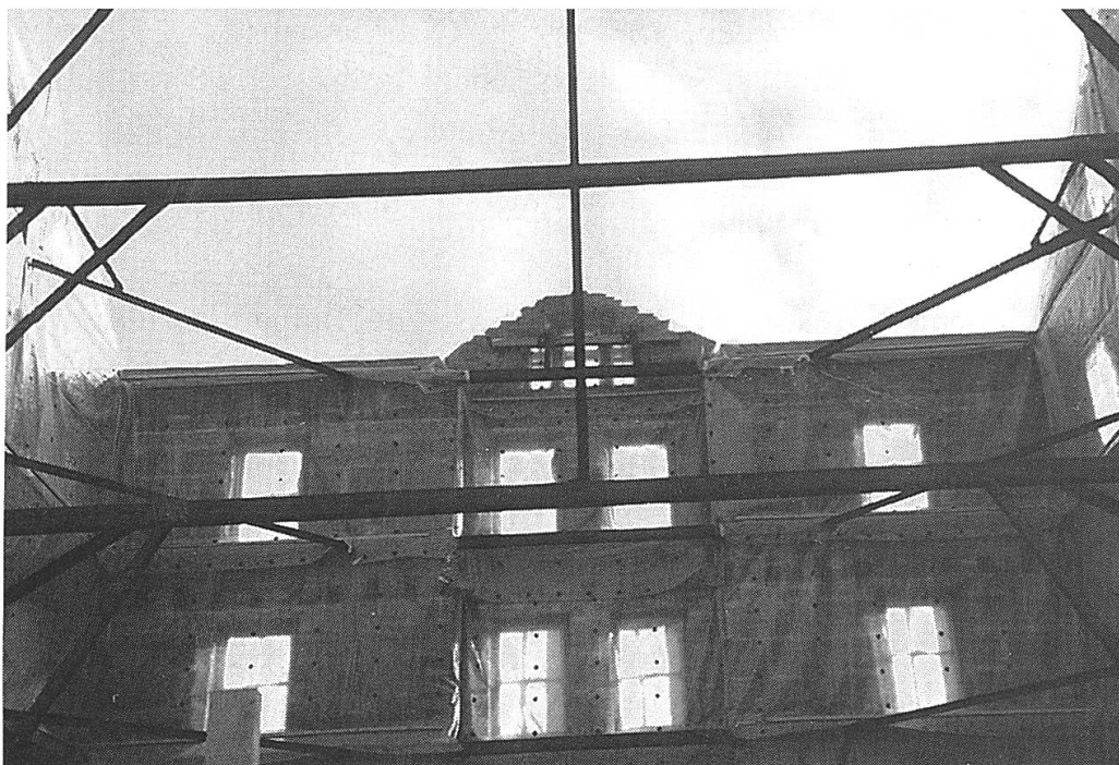
Im Umbau bleiben vom alten «Dälli» nur drei Fassaden bestehen (Foto: Hans Aeschlimann).
