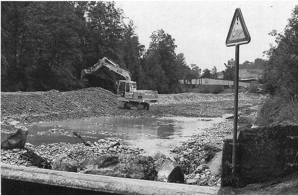
Nachdem die rund zwei Meter hohe Schwelle in der Emme auf der Höhe des Freibades unterspült und ein Teil der Uferpartie eingestürzt war, wurde das Gefälle mit einer neuartigen Blockrampe auf eine Strecke von 15 Meter verteilt. – Unser Bild: Der Flusslauf wird im September 1991 vorübergehend umgeleitet (Foto: Hans Heiniger/BT).
