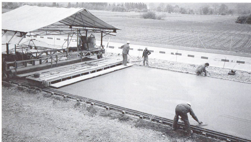
Mise en place d'un revêtement routier en béton recyclé contenant des fumées de silice (N 13).
