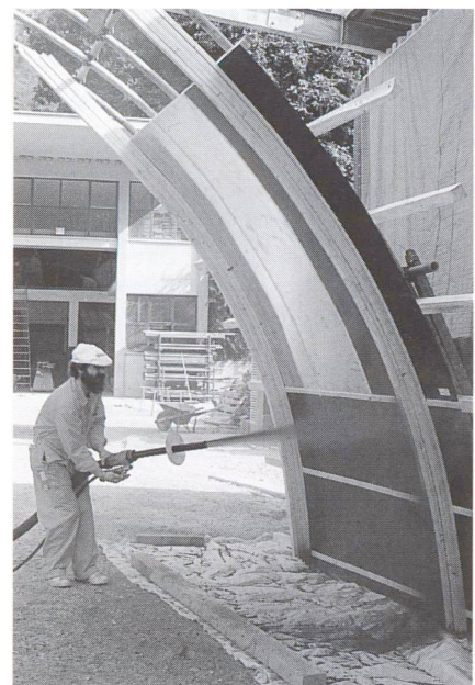
Les essais préalables effectués au chantier de l'entreprise ont fourni d'importants renseignements pour l'exécution des travaux en béton projeté.
