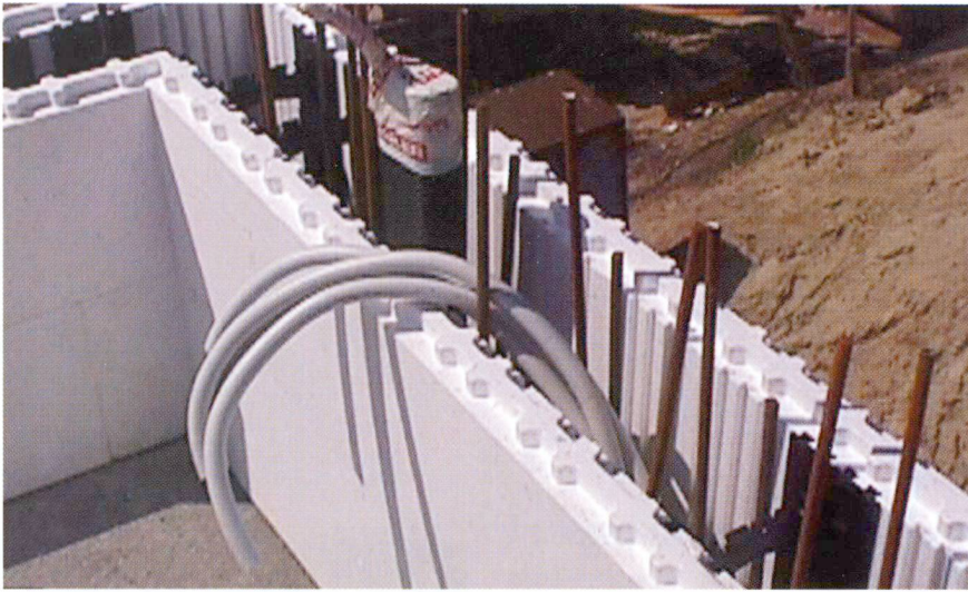
Des tuyaux vides peuvent également être logés dans les murs pour les installations domestiques.
