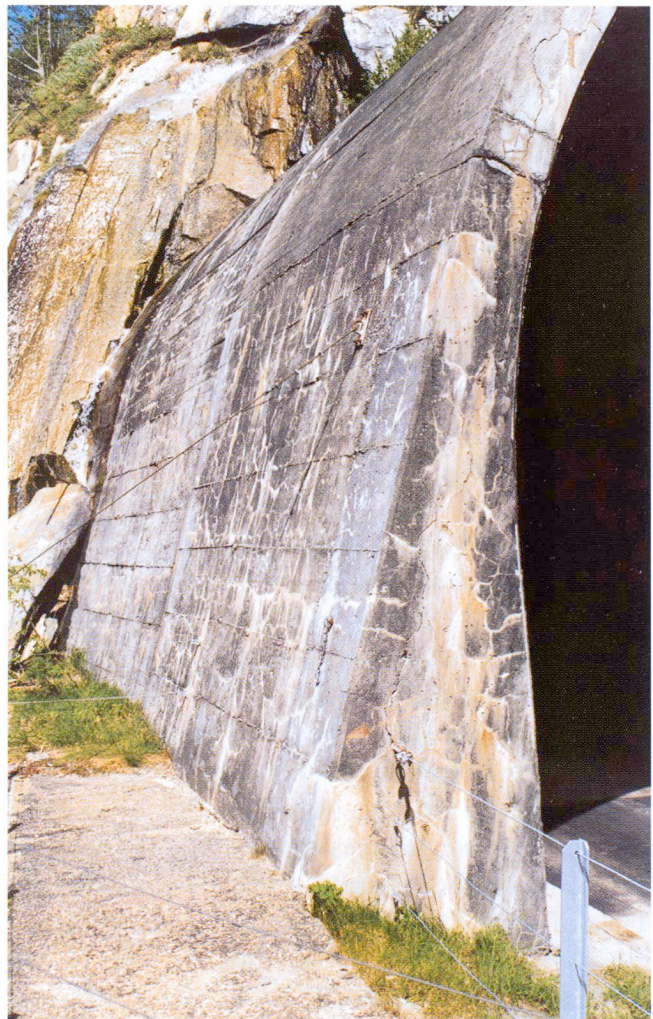
Fig. 5 Superposition de fissures dues à la RAG, à la corrosion et à des contraintes statiques, avec dépôts calcaires.
