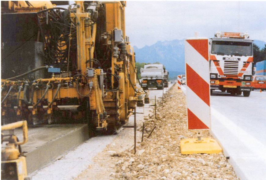
Fig. 3 Les chaussées en béton modernes sont mises en place avec des finisseuses à coffrage glissant.
