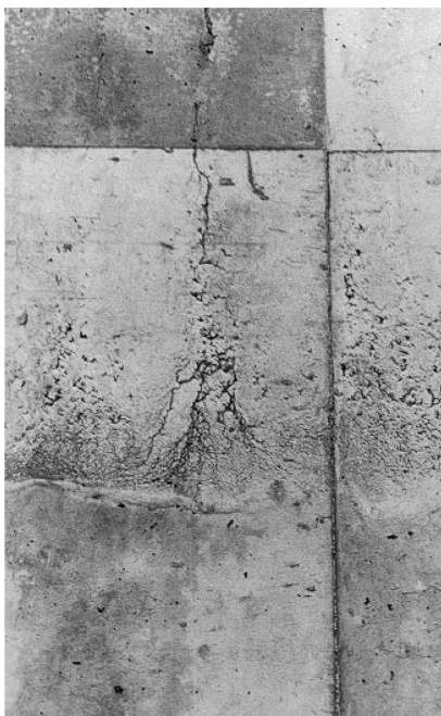
Restitution d'eau dans la zone d'un joint de bétonnage.
