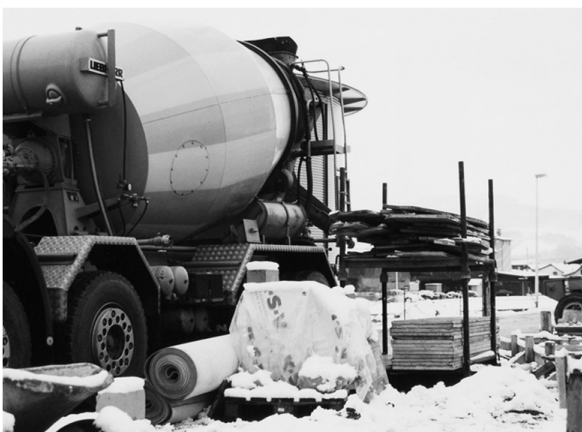
Le béton prêt à l'emploi est utilisable en toute saison, également en hiver, si l'on prend les mesures nécessaires [18].
