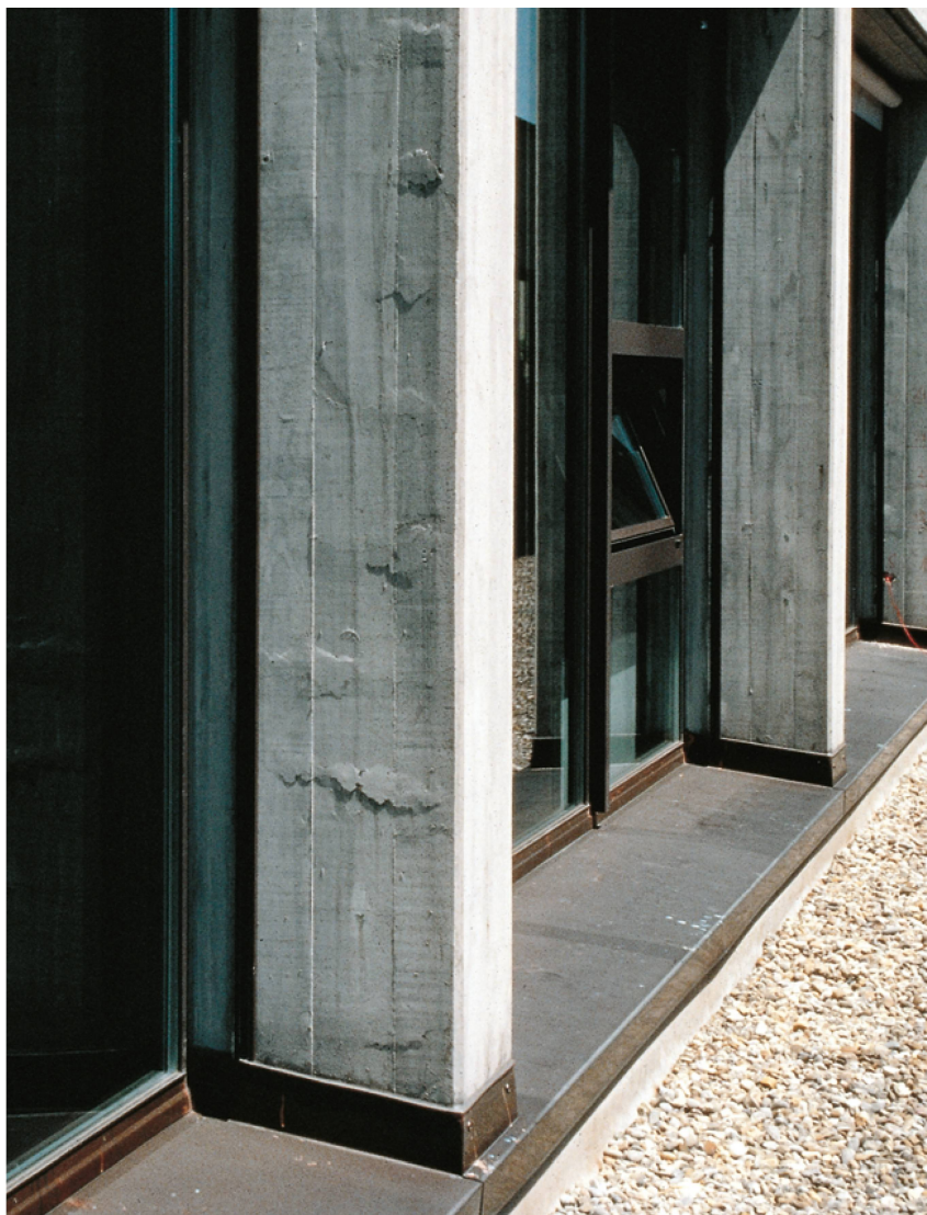
Dégâts dus à la corrosion sur des piliers.
