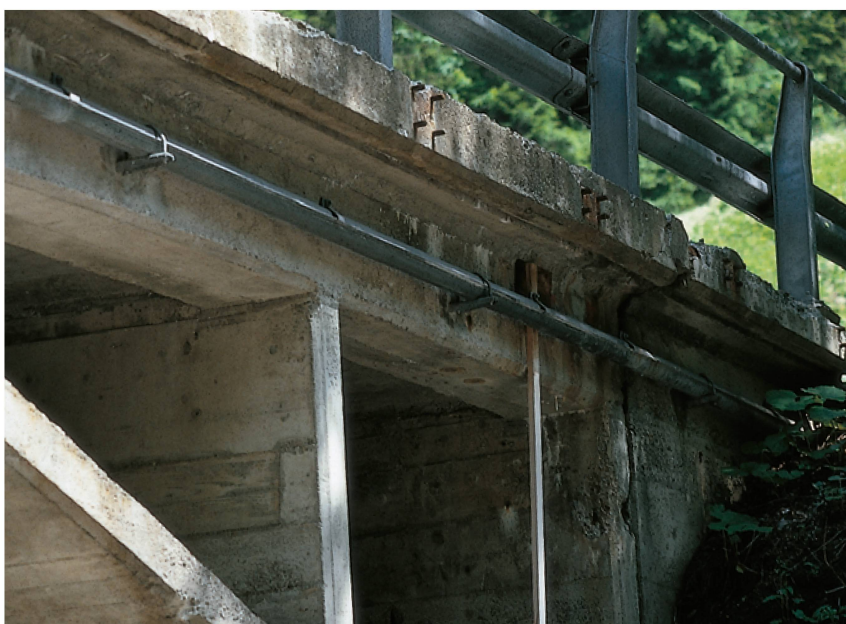
Partie de pont exigeant une réfection.
