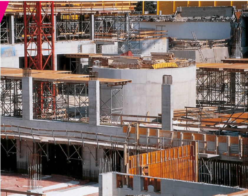
Utilisation de CEM II/A-L 32,5 R en grande quantité: nouveau bâtiment du laboratoire de l'EPF Hönggerberg, Zurich.
