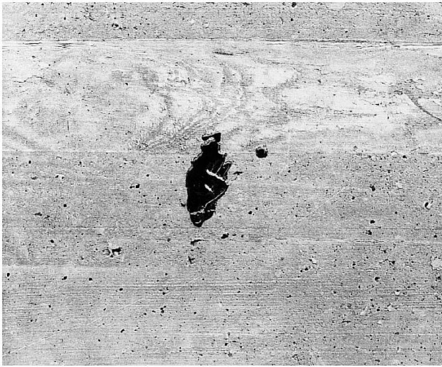
Fig.1 Surface de béton souillée par du bitume.
