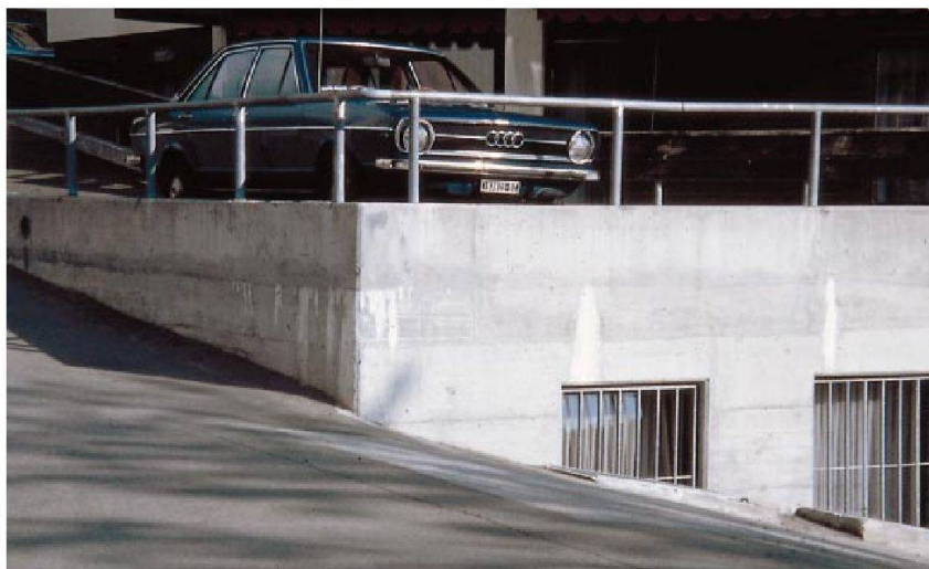
Murs en béton apparent avec efflorescences de chaux.
