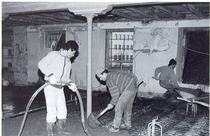
Rénovation d'un ancien bâtiment au moyen du système mixte bois-béton (béton léger BL 20/10, masse volumique 1,5 kg/m 3 ).
