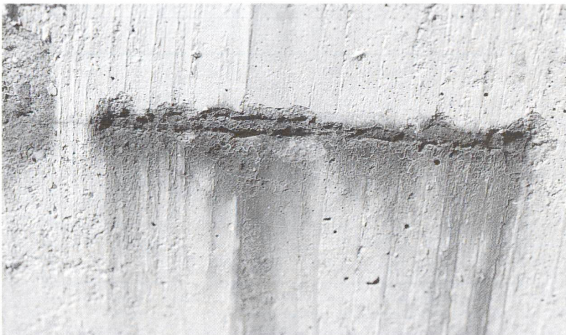
Eclatements résultant de la corrosion de l'armature.
