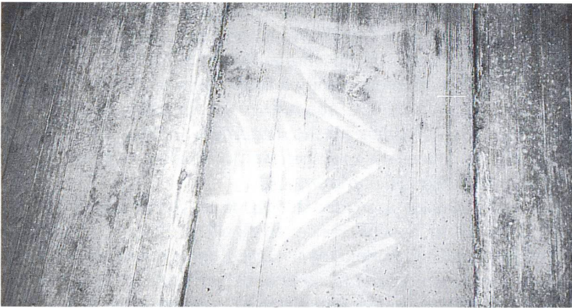
Appliqués en trop forte concentration, les produits de décoffrage peuvent provoquer le farinage ou le poudrage des surfaces de béton. (Photos: TFB)
