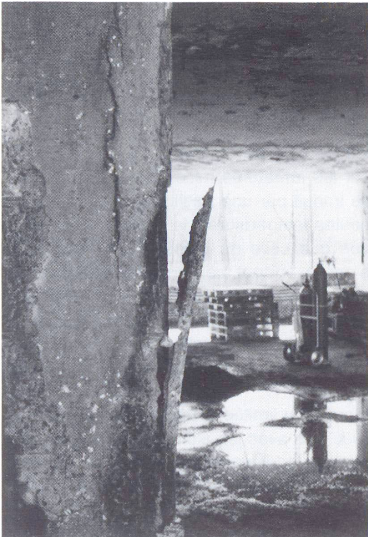
Fig. 4. Eclatement du béton sur un pilier incendié.
