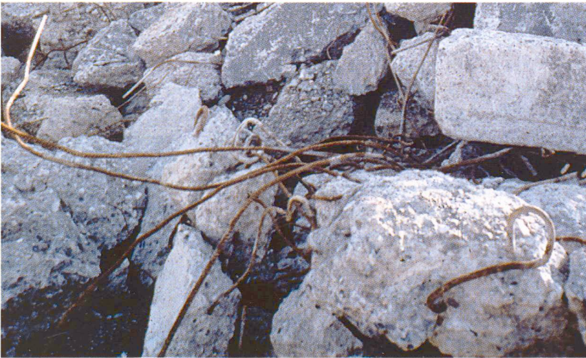
Béton de défonçage de route brut, avec treillis d'armature, qui, après un traitement approprié, s'est transformé en une précieuse matière première utilisée pour l'aménagement de la N 13 dans la partie saint-galloise de la vallée du Rhin. (photo: Routes en béton SA)
