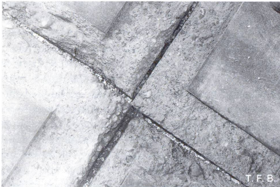
Fig. 7 Le doublage de joints souvent utilisé, composé de 10 mm et plus de produit mousse, est en l'occurrence inadéquat. De plus, les joints ne sont pas rectilignes. Dans la zone des arêtes, le béton dur a éclaté et il a fallu le remplacer. Conclusion: il faut exécuter soigneusement le coffrage latéral et utiliser des bandes couvre-joints de moins de 6 mm d'épaisseur.
