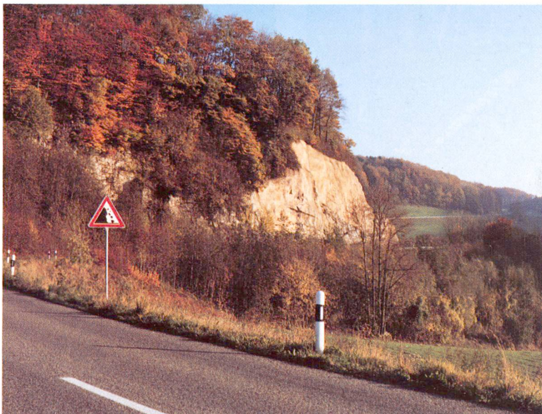
Fig. 18 Les travaux de stabilisation sur la paroi rocheuse au moyen de béton projeté et de treillis ont été limités à l'indispensable, mais le danger de chutes de pierres a tout de même pu être éliminé dans une large mesure
