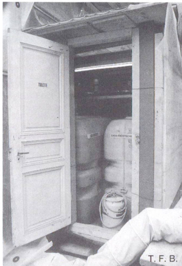
Fig.4 Entrepôt avec bardage et isolation pour les réservoirs contenant les adjuvants, logé dans la charpente métallique du malaxeur et chauffé continuellement.
