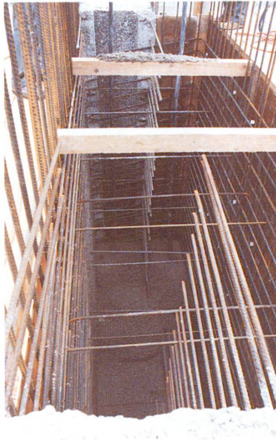
Fig. 6 Début des travaux de bétonnage. On voit les robustes écarteurs de l'armature.
