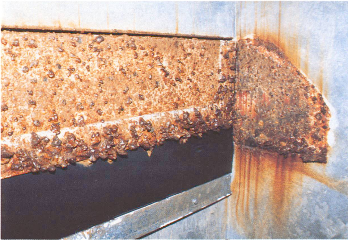
Fig. 5 Dégâts par corrosion au clapet de retenue d'un filtre à charbon actif après 5 ans d'exploitation. Corrosion aggravée à cause de l'alternance eau-air avec ozone (exécution idem fig. 3).
