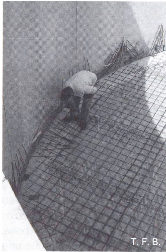
Fig. 11 Pose de l'armature de la dalle de fond puis bétonnage et précontrainte des parois.
