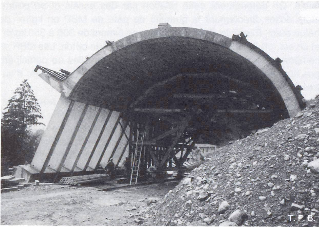
Fig. 5 Tunnel de Spiezwiler (Arge Frutiger, Marti, Lanz). Partie hors de terre au sud. Fondation enterrée sans air occlus. Piliers préfabriqués avec entraîneur d'air. Voûte bétonnée sur place avec adjonction de MBP. Il est actuellement prévu d'exécuter la voûte intérieure du tunnel proprement dit également en béton à air occlus avec adjonction de MBP.
