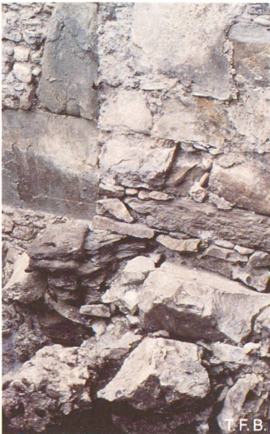
Fig. 20 Face extérieure d'un mur de cave qui a dû être consolidé.
