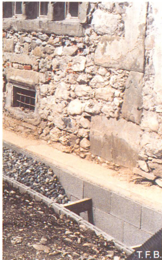
Fig. 21 Le même mur après consolidation au béton fluidifié (chaux hydraulique comme liant). Chemise de drainage selon fig. 19.
