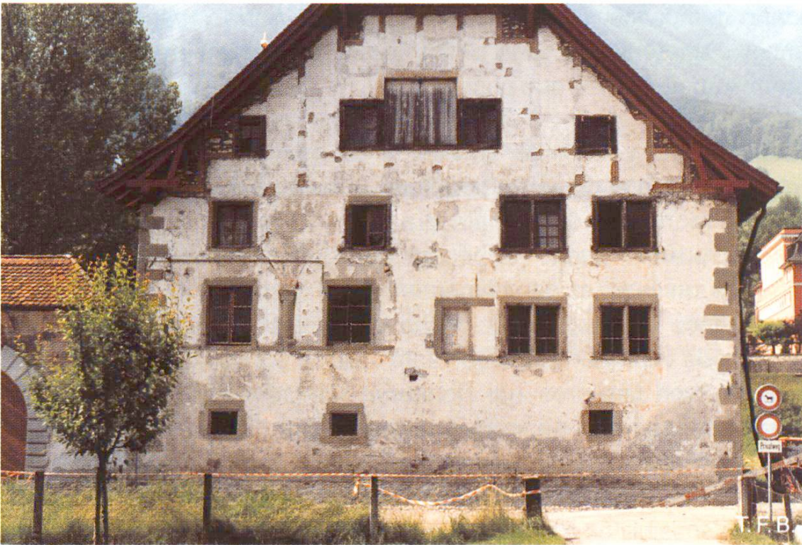
Fig. 2 L'humidité montant à partir des fondations laisse des traces bien visibles (Maison de Winkelried, Stans, façade nord, juillet 1987).
