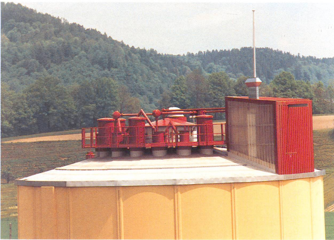
Fig. 7 Installations placées sur le toit
