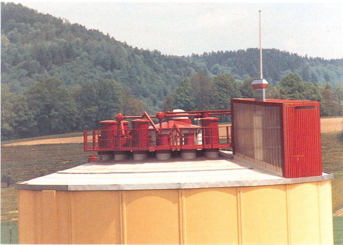
Fig. 7 Installations placées sur le toit
