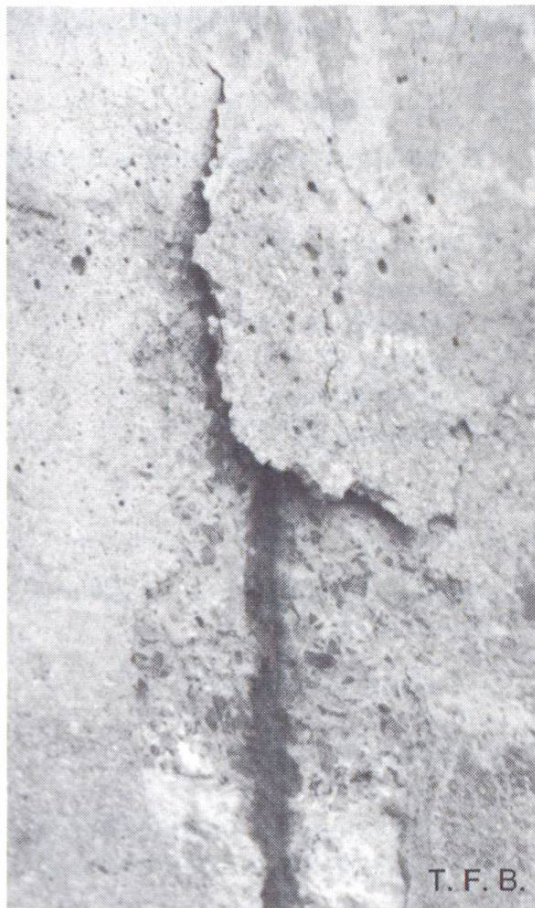
Fig. 5 Gonflement et écaillage provoqués par la corrosion de l'armature.
