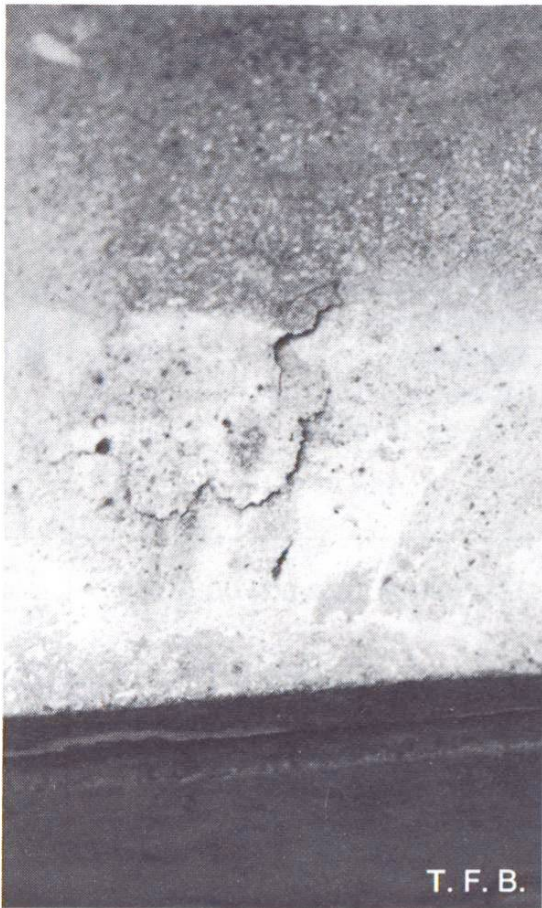
Fig. 4 Gonflement. La cause du dégât n'est pas encore visible.
