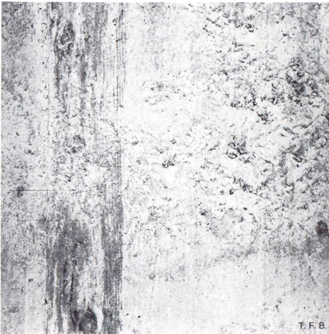
Fig. 3 Ségrégation dans un mélange trop pauvre en sable, impropre à donner un béton apparent satisfaisant.
