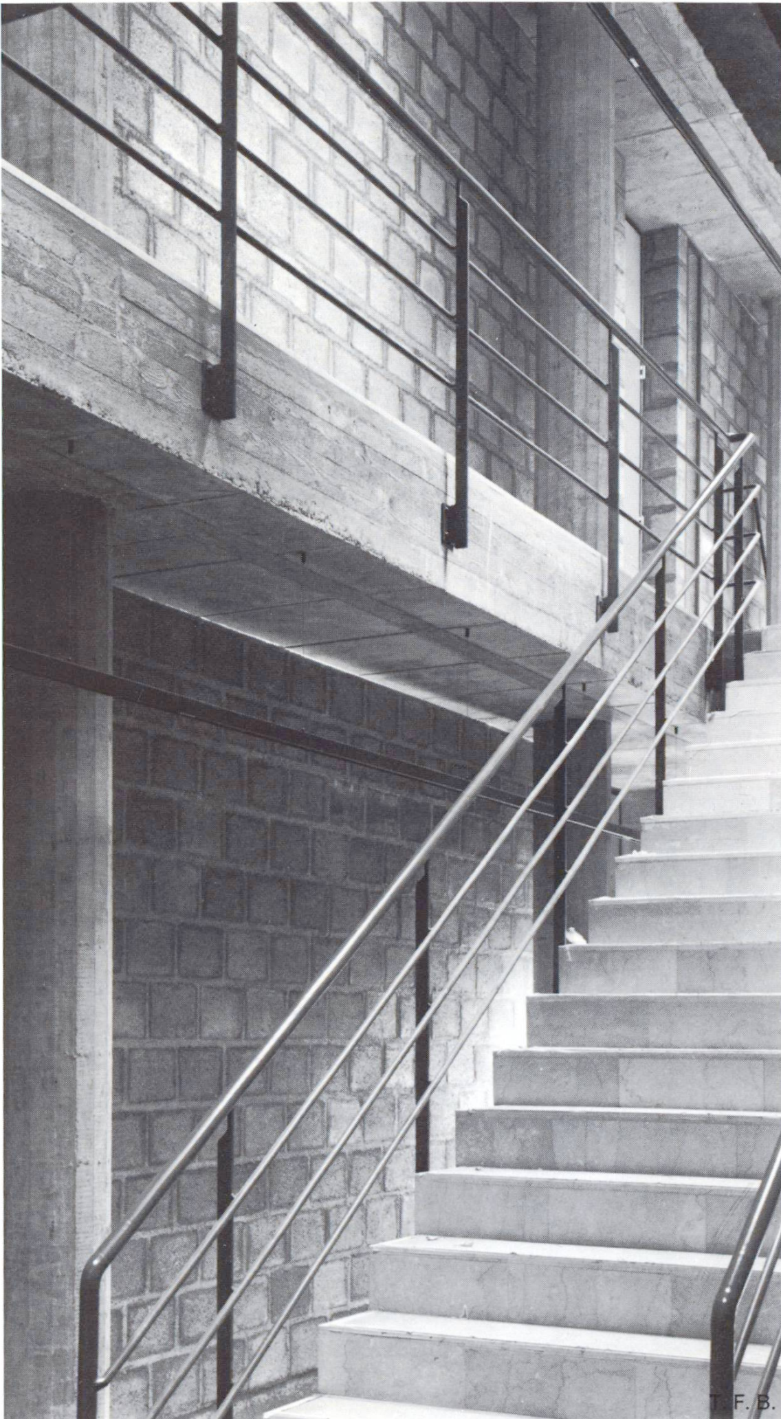
Fig. 5 Maçonnerie apparente en béton pour le bâtiment de la direction d'une fabrique.
