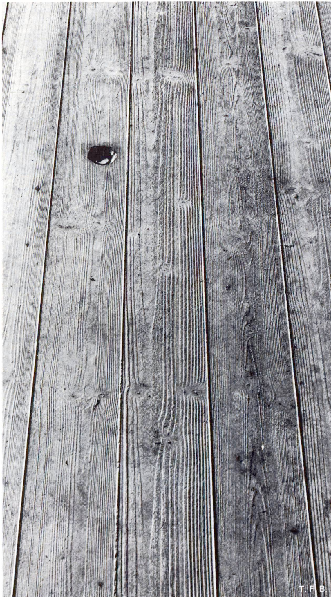
Fig. 2 Surface du béton obtenu par le coffrage de la figure 1.
