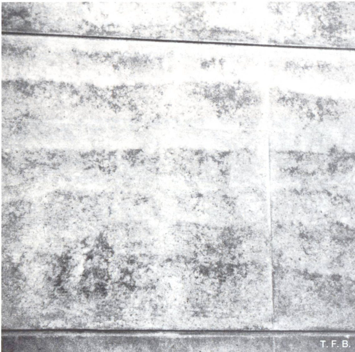
Fig. 3 Détail de la figure 1. On distingue l'effet des positions successives des vibrateurs ainsi que les traces indirectes des éléments du coffrage.
