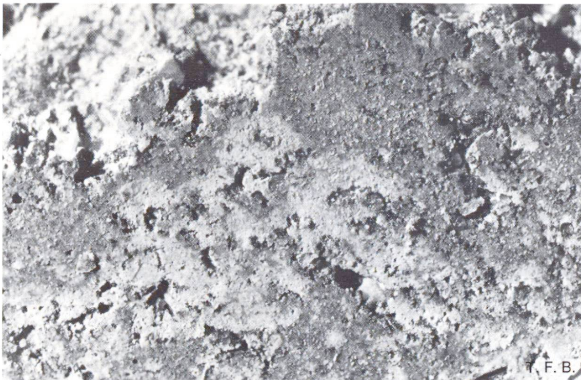
Fig. 1 Surface d'un béton sorti d'un coffrage lisse (agrandissement, la largeur de la photo correspond à 10 mm). On distingue des fragments de gel de ciment de teinte claire ou foncée, le clair ayant été provoqué par un enrichissement local en eau. Le gel légèrement vitreux laisse transparaître des grains foncés de ciment non hydraté. On remarque aussi des trous noirs et des efflorescences de chaux sous forme de points clairs qui contribuent à donner la teinte générale.
