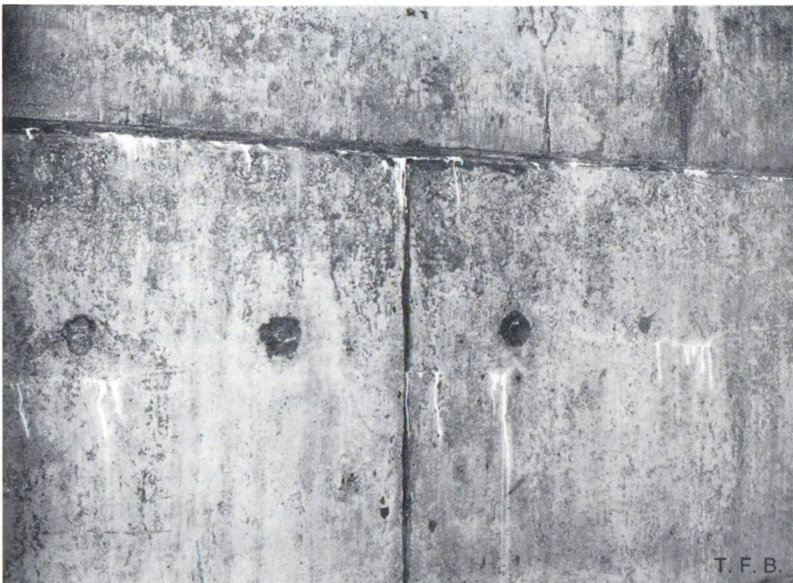
11. Calcification d'un joint de reprise et de fissures de retrait
