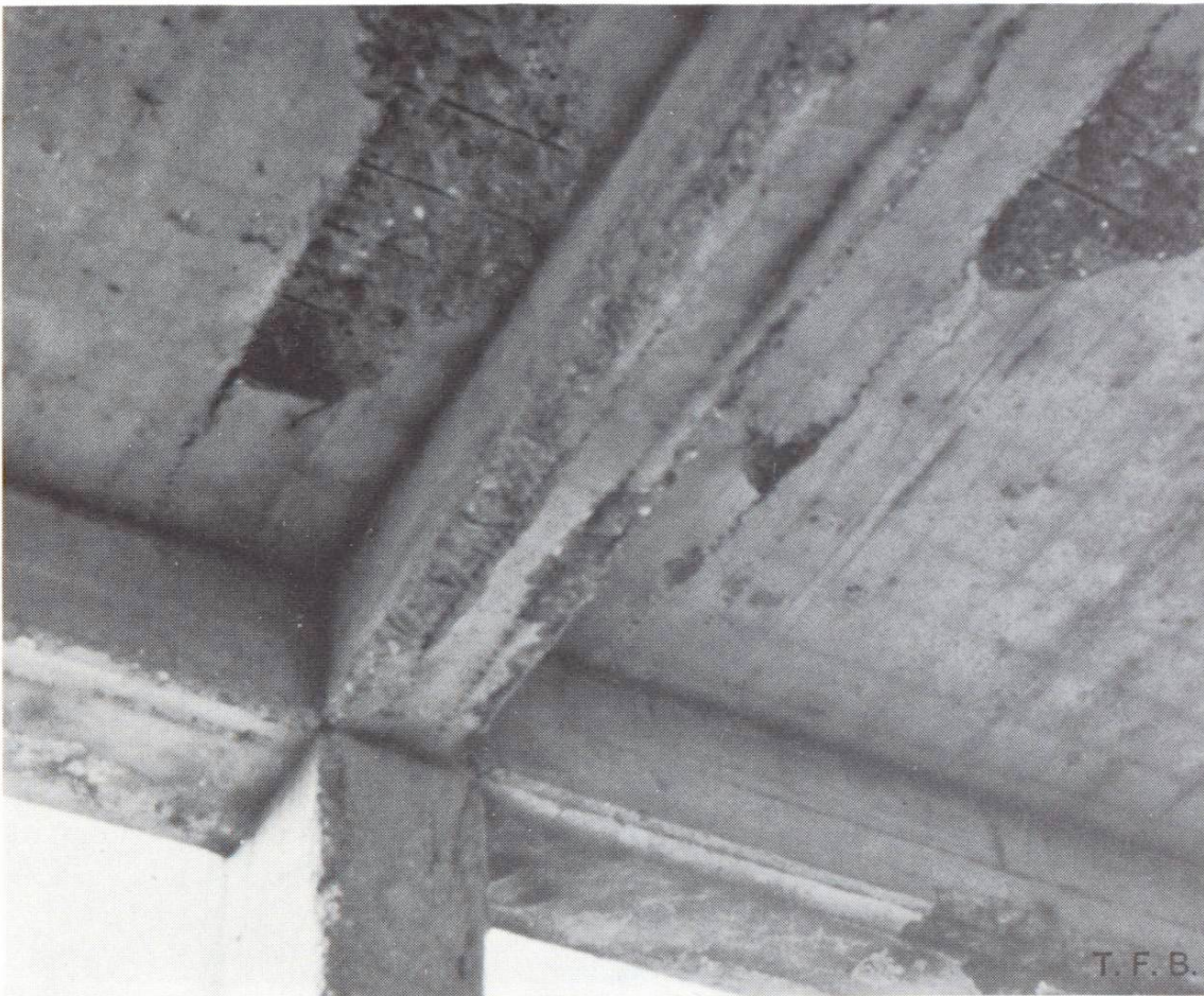
Fig. 3 Les arêtes des poutres porteuses sont particulièrement exposées aux effets de la chaleur d'un incendie. Malgré cela, de telles constructions ne s'effondrent que tout à fait exceptionnellement.
