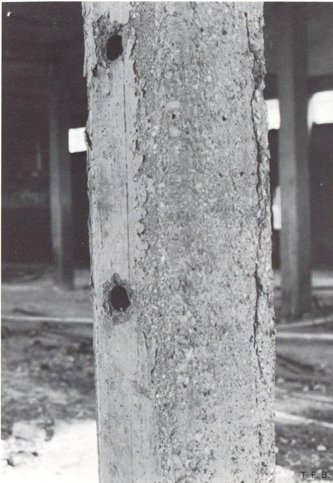
Fig. 2 Un pilier en béton conservant toute son efficacité après un violent échauffement de l'une de ses faces.
