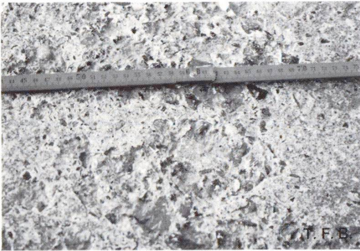
Fig. 2 Ecaillage par gel en présence de sel sur une marche d'escalier.
