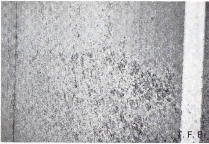
Fig. 1 Dégâts de gel en présence de sel sur une route en béton.
