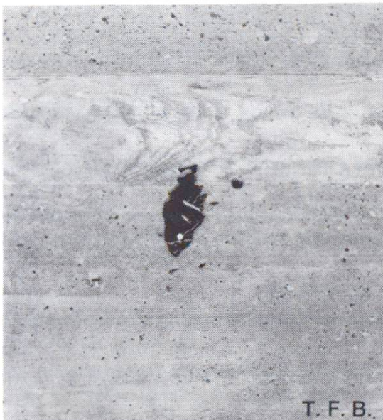
Fig.1 Surface de béton avec tache de bitume.
