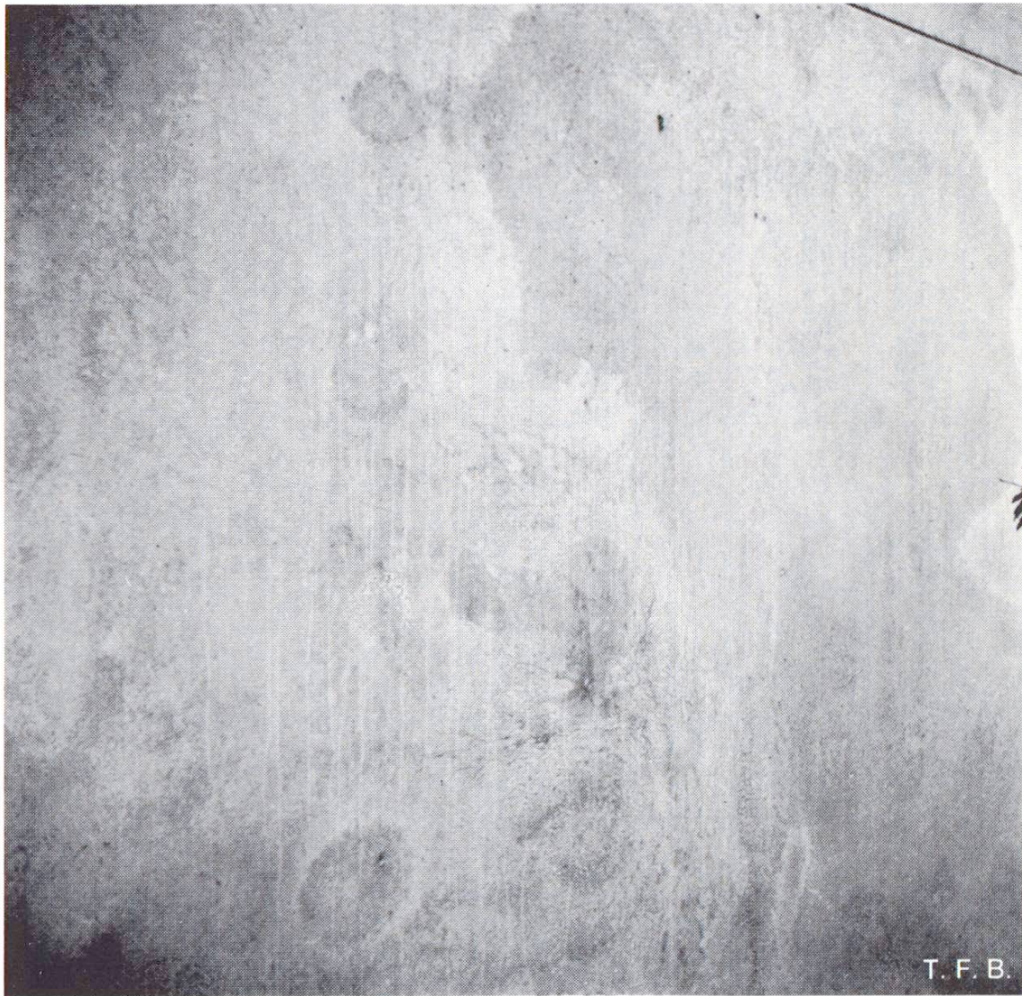
Fig. 2 Laminé lors de la mise en place du béton, ce produit de décoffrage pâteux de type C laisse des marques à la surface du béton.
