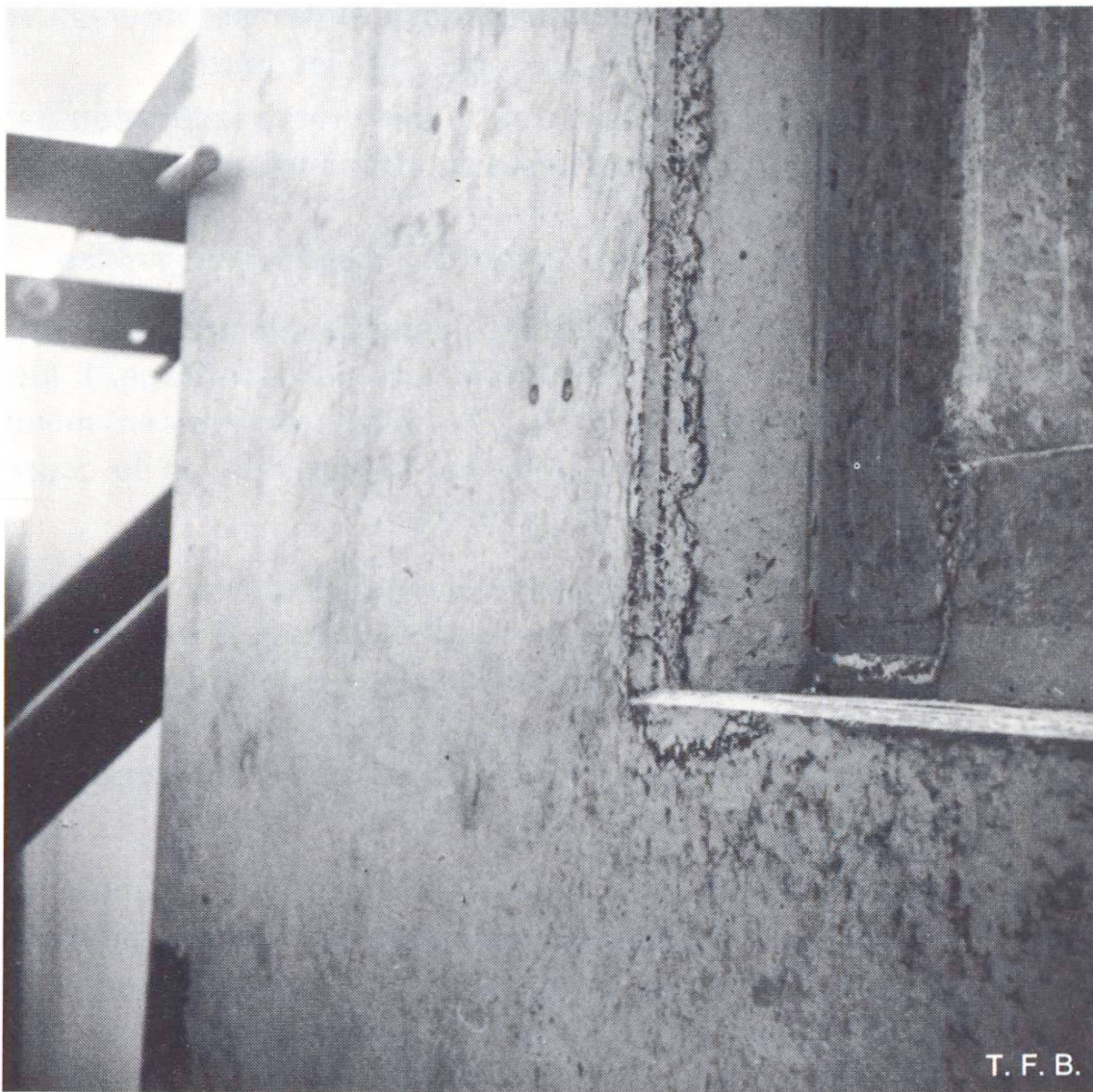
Fig. 2 Conséquence d'un manque d'étanchéité du coffrage de l'arête. Le béton a été amaigri à cause de la fuite du mortier.
