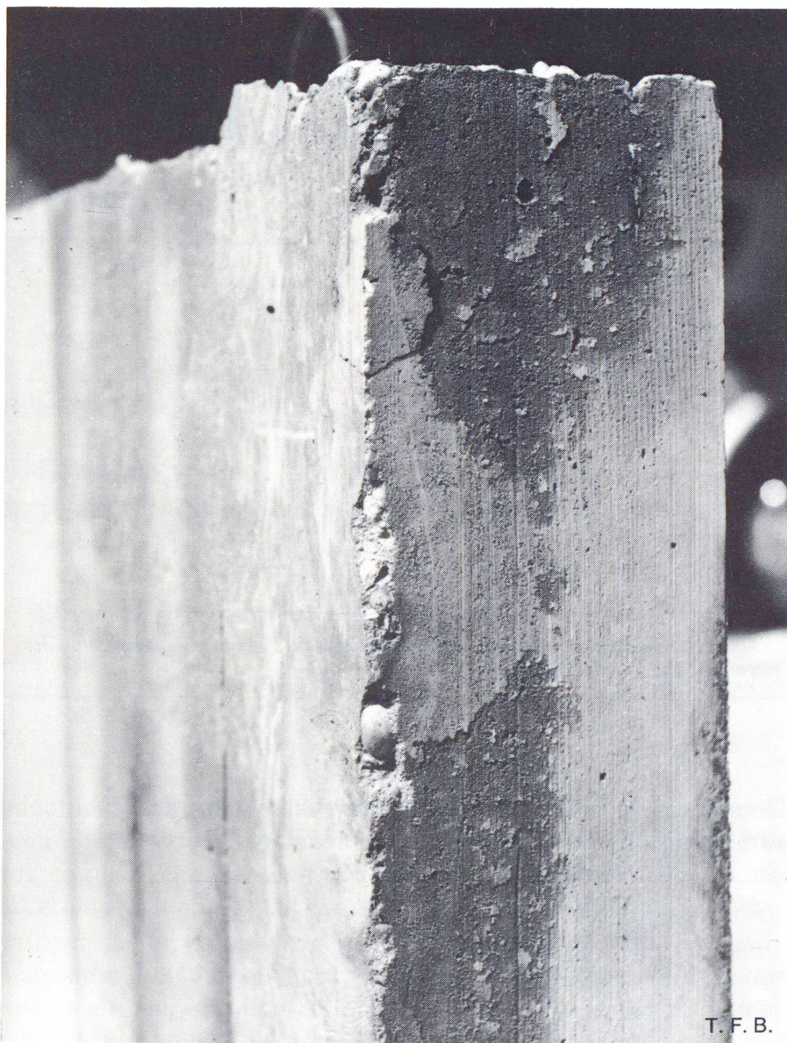
Fig. 1 Arête rompue sous l'effet de la dilatation du coffrage en bois.
