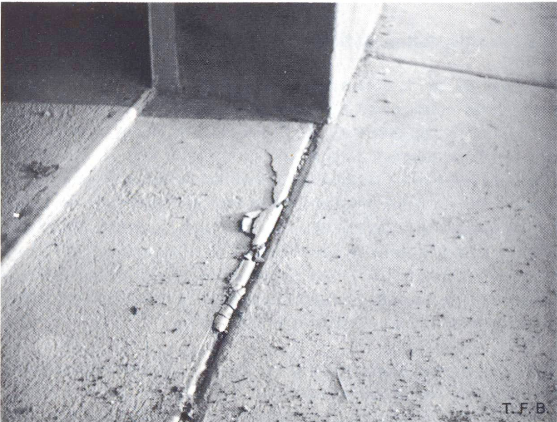
Fig. 4 Béton d'une arête, amaigri et détérioré par le gel en raison d'un excès de zèle et probablement d'un apport d'eau supplémentaire lors du façonnage de l'arête.
