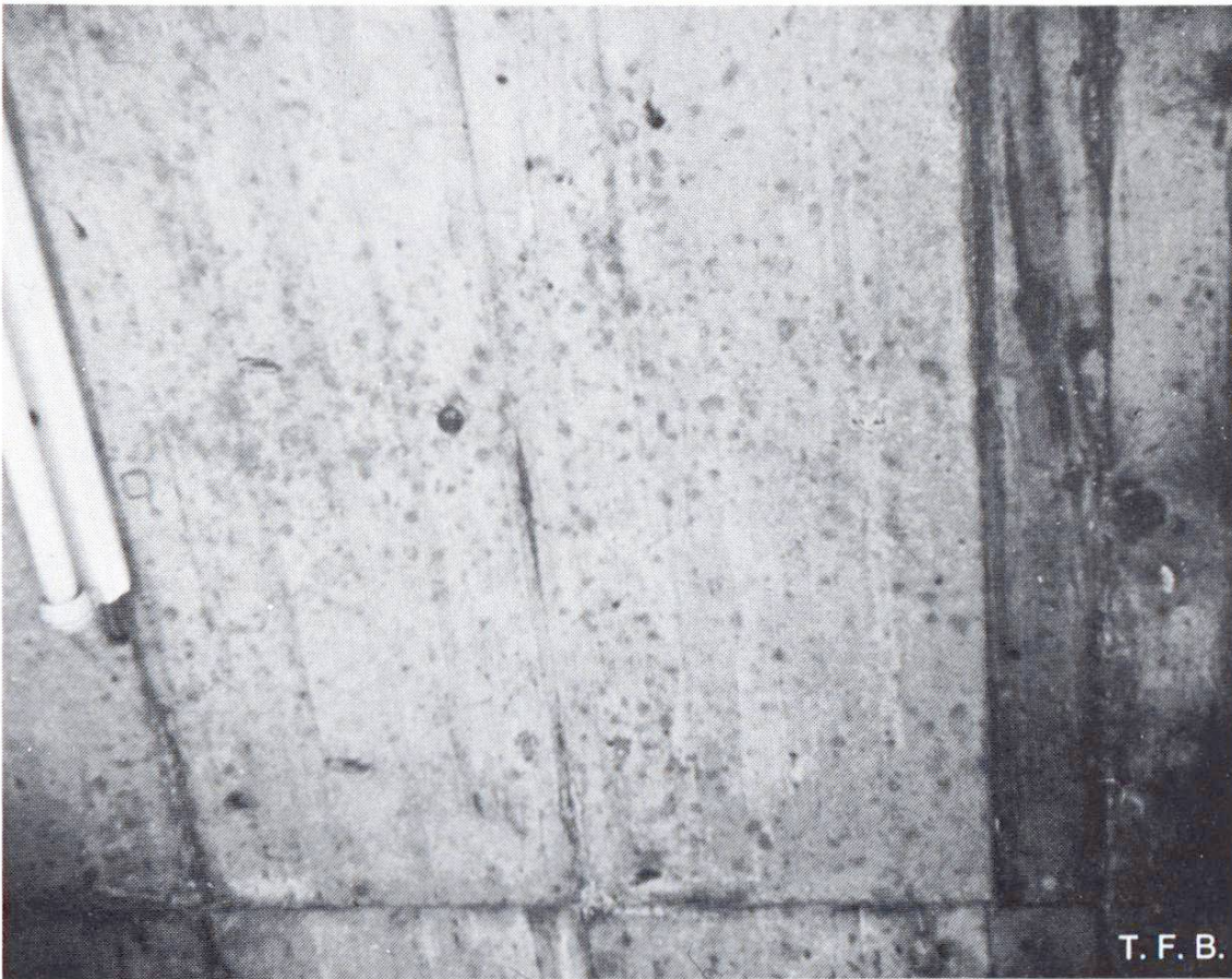
Fig. 4 Dans un béton trop fluide, les gros éléments se sont enfoncés et il s'est produit une séparation entre l'eau et le ciment à la surface du coffrage. Les gros granulats se manifestent par des points foncés dont la répartition irrégulière est due à une vibration irrégulière, elle aussi.
