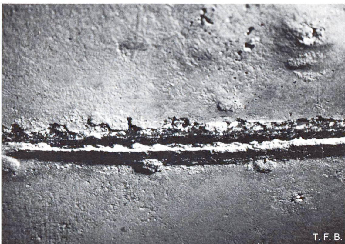
Fig. 11 Armature rouillée placée beaucoup trop près de la surface.
